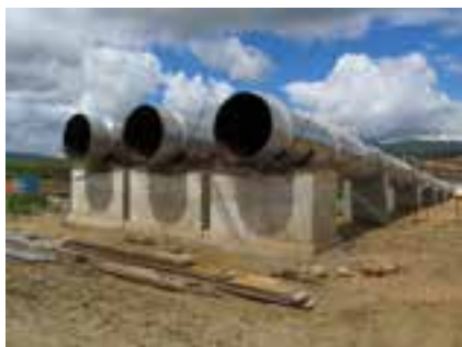
Sifão Trecho Aéreo
