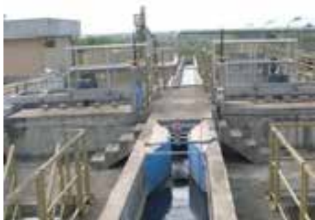
ETE Cubatão – tratamento preliminar
