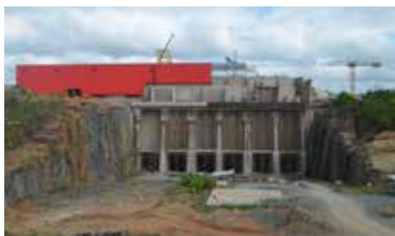
Circuito hidráulico - Vista geral
