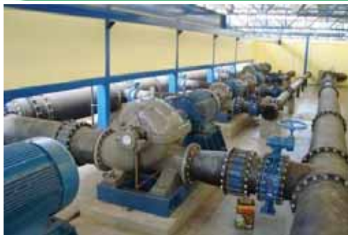
Estação elevatória de água tratada 07
