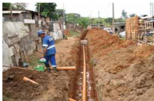
Esgotamento sanitário no Parque Oziel
