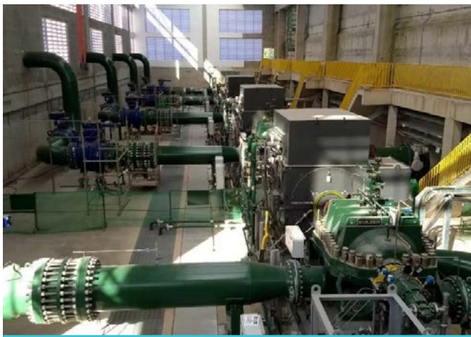
Estação de bombeamento - Sistema Produtor São Lourenço (SP)
