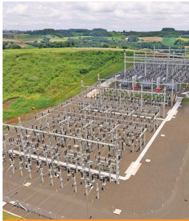
SE 230 - 138 kV Pinhalzinho (SC)
