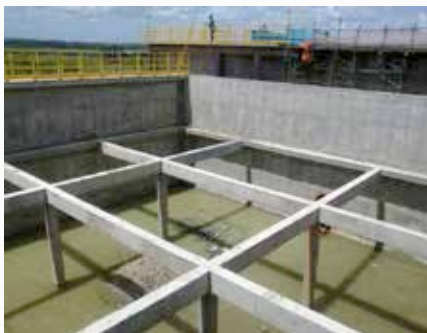
ETE – Sarandi - Reatores
