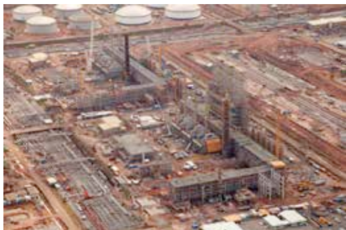
Instalações da Unidade de Coqueamento Retardado (UCR)
