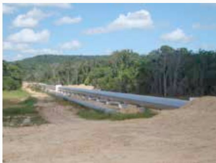
Trecho aéreo da adutora de água tratada
