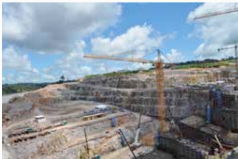
Vista geral do circuito de geração
