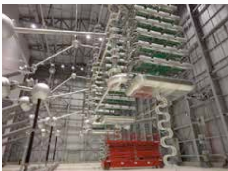
Sala de Válvulas - SE Coletora Porto Velho
