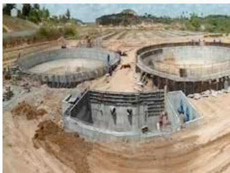
Decantadores ETE ERQ Sul
