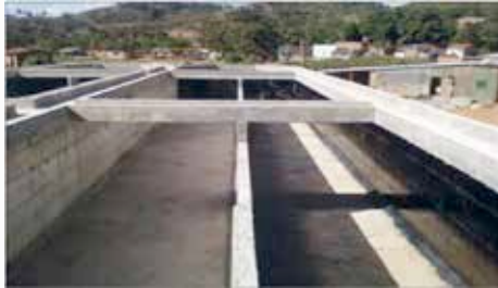
Aerador da ETE – São Francisco do Conde
