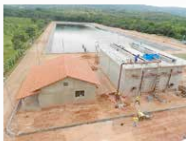
ETE de Buenópolis/MG
