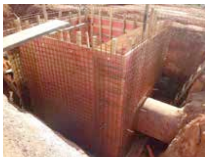
Caixa de proteção de ventosa das sub-bacias 8 e 9
