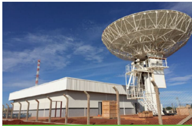
Antena Estação de Acesso Gateway, Campo Grande-MS
