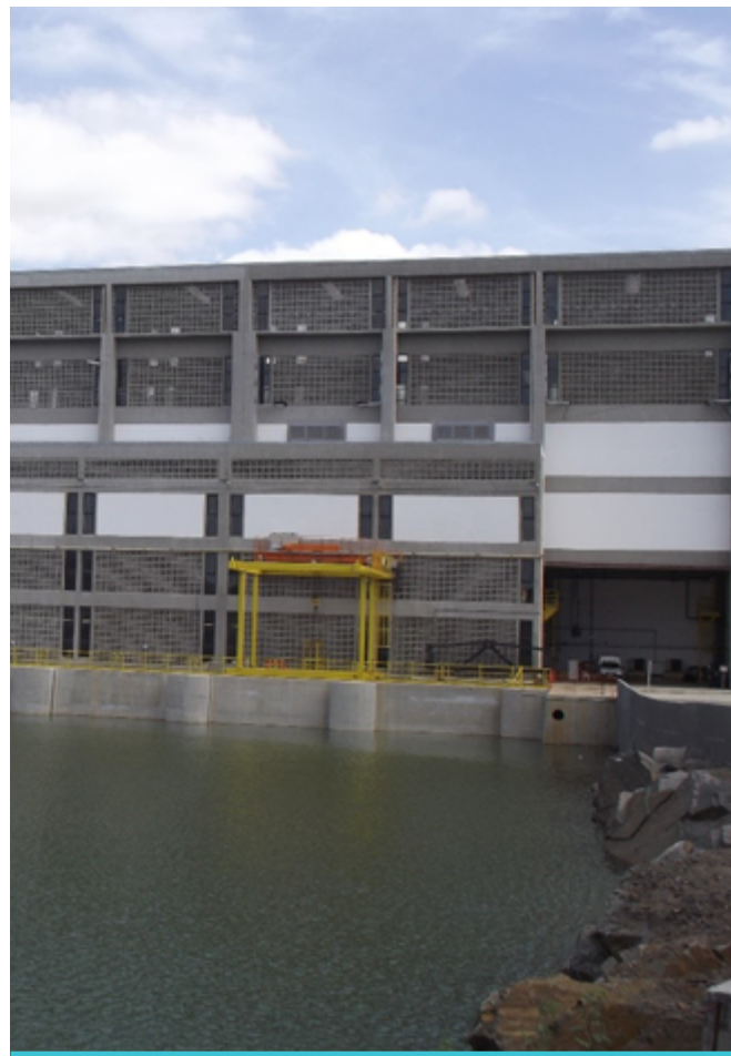
Estação de Bombeamento – EBI-2 – Eixo Norte do PISF (PE)
