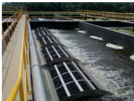
ETE São Francisco
