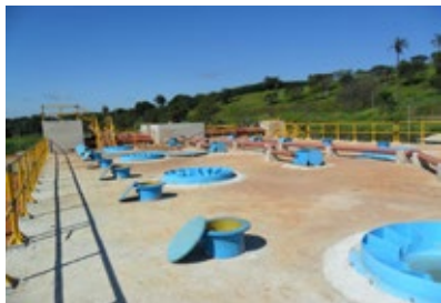
Reatores da ETE em Pedro Leopoldo
