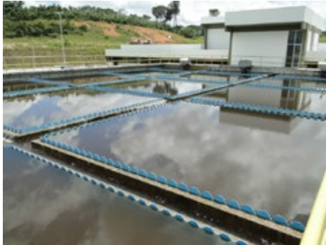
Decantadores da ETA
