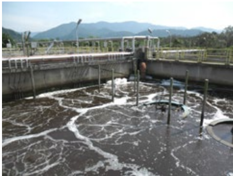
ETE Mongaguá – Tanque de aeração
