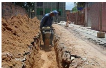
Compactação do solo em Simões Filho
