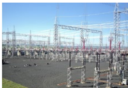
Setor de 500 kV – SE Araraquara II
