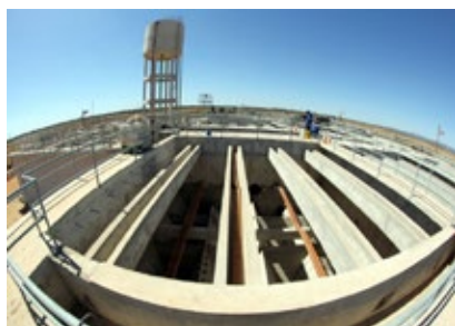
Estação de Tratamento de Águas
