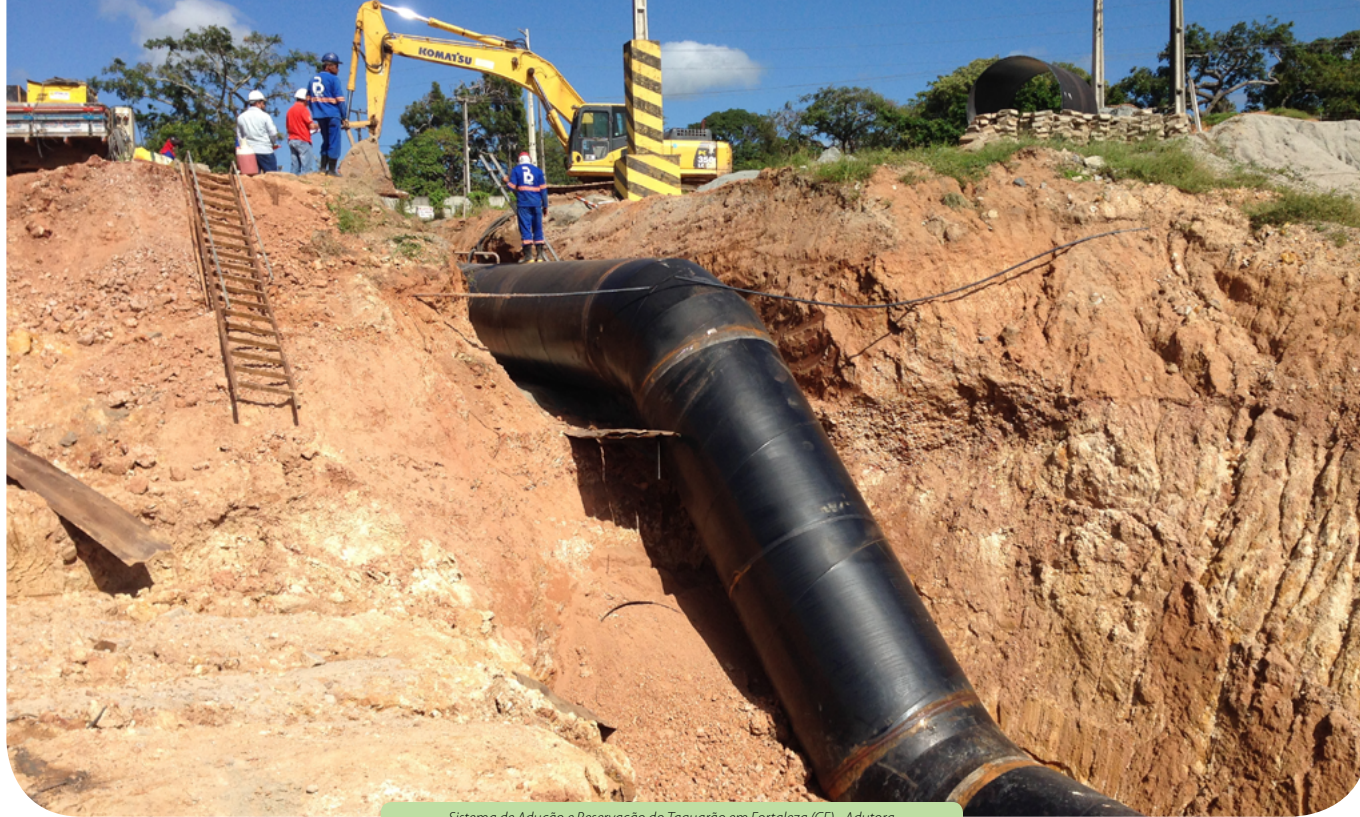
Sistema de Adução e Reservação do Taquarão em Fortaleza (CE) - Adutora
