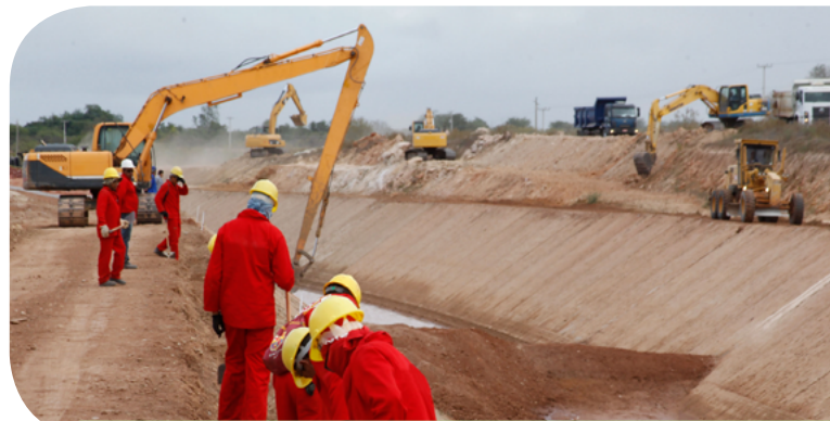
Eixo Norte do Projeto de Integração do Rio São Francisco (PE) - Retomada das obras da Meta 1N
