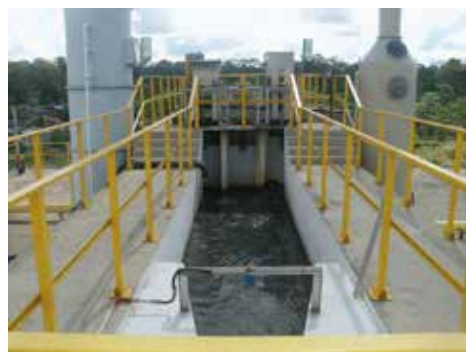
ETE São Francisco
