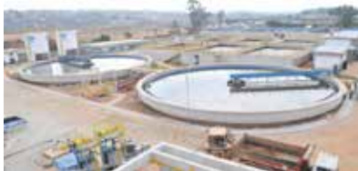
Decantadores da ETE São João
