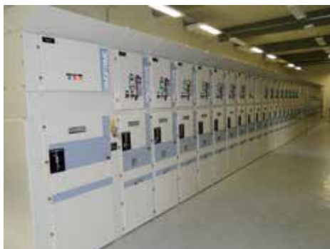
Central de controle operacional da ETA
