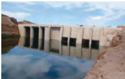
Vista do vertedouro e da tomada d'água
