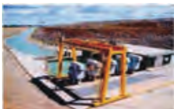
Estação de bombeamento 2
