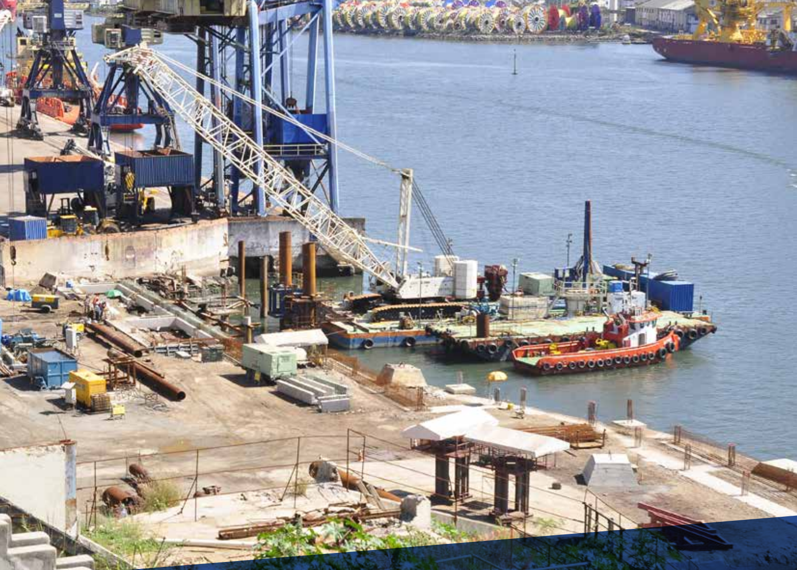
Obra para a construção de berços nos dolphins do Atalaia no Porto de Vitória (ES)
