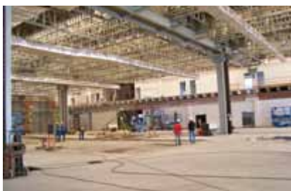
Área do Terminal Remoto
