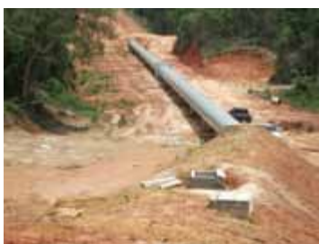
Trecho aéreo da adutora de água bruta
