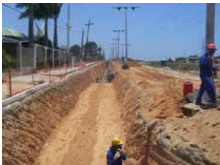
Trecho V – Tubulação
