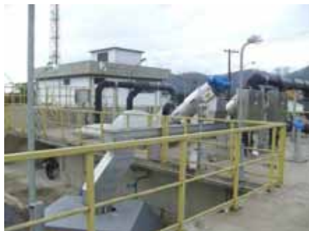
Estação de pré-condicionamento de esgoto – Praia Grande
