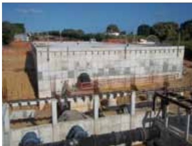
Reservatório de água bruta
