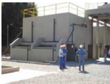
Reator Anaeróbio de Tiroso/MG
