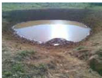
Construção de barraginhas na mesorregião de águas emendadas no Vale do Uruçuia
