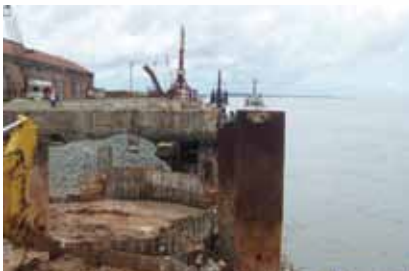
Arrasamento de gabiões do Berço 102
