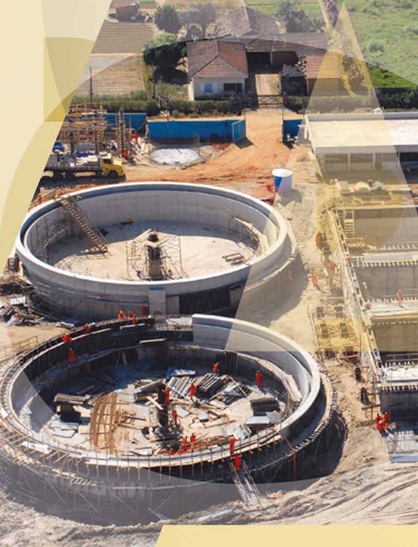
Estação de Tratamento de Esgoto - Guarulhos • SP
