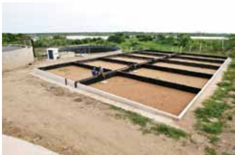
Leito de secagem da ETE Olaria
