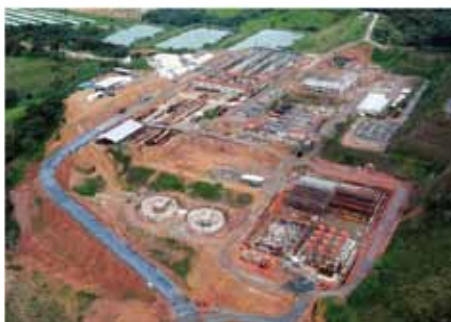
Estação de Tratamento de Água
