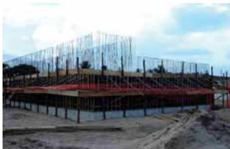
Reator da ETE de Barra dos Coqueiros
